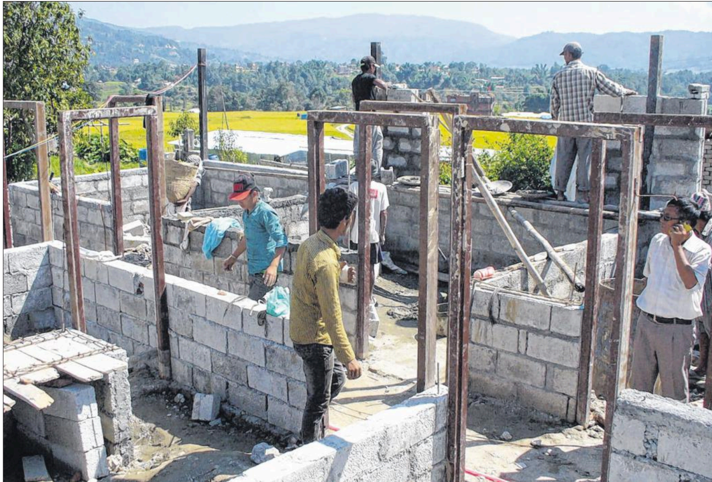
Das Kinderheim des Waginger Nepalhilfevereins wurde bei dem Erdbeben so schwer beschädigt, dass die Buben und Mädchen ausziehen mussten (wir berichteten). Nun wird ein neues Haus außerhalb von Kathmandu errichtet.
